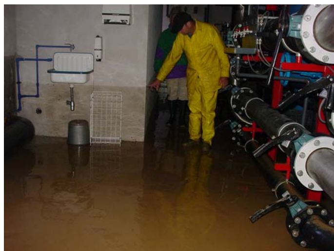
Parkbad Der Wasserstand im Pumpenhaus
